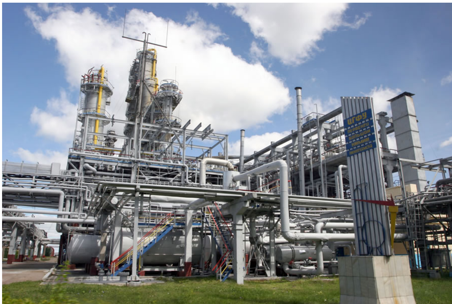
Установка по переработке газового конденсата на ОАО «Нижнекамскнефтехим».
